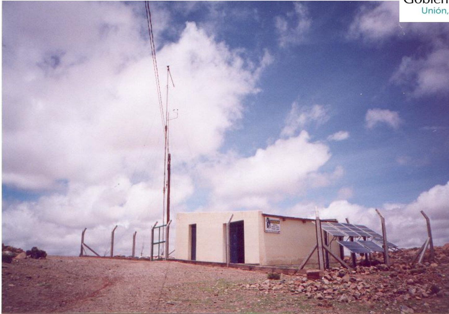
Sistema Híbrido Solar-Térmico-Eólico de la localidad de Pastos Chicos, 33 Usuarios 17 kVA / 1450 Wp / 600 W Dpto. Susques
